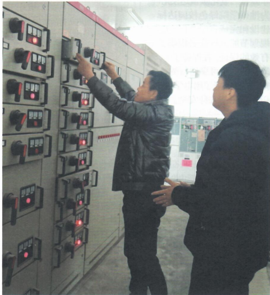
学校电工在开闭所检查配电系统运行状况。
