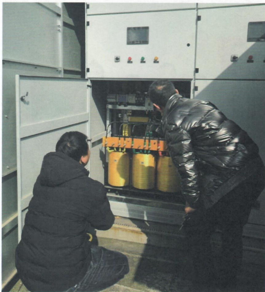
工作人员在节电柜前查看电压稳定情况。
